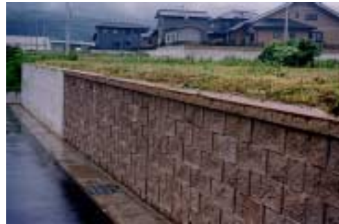
写真－6 栗生造成地（仙台：震度5弱程度）
